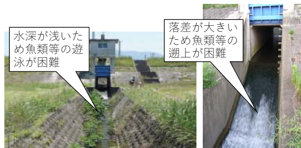
図一6 河川と堤内地の横断的な移動経路の連続性が失われている例
