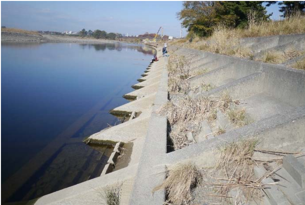
図-1 覆土が流失し単調な水際線が連続した事例
