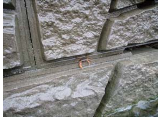
河岸のり面を移動中のサワガニ。河岸は空積ブロック護岸（擬木模様）※
