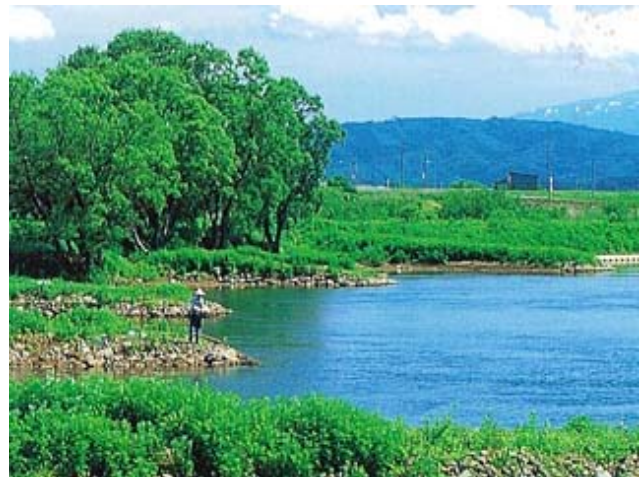
図-11 水衝部に設置された水制工（子吉川）
