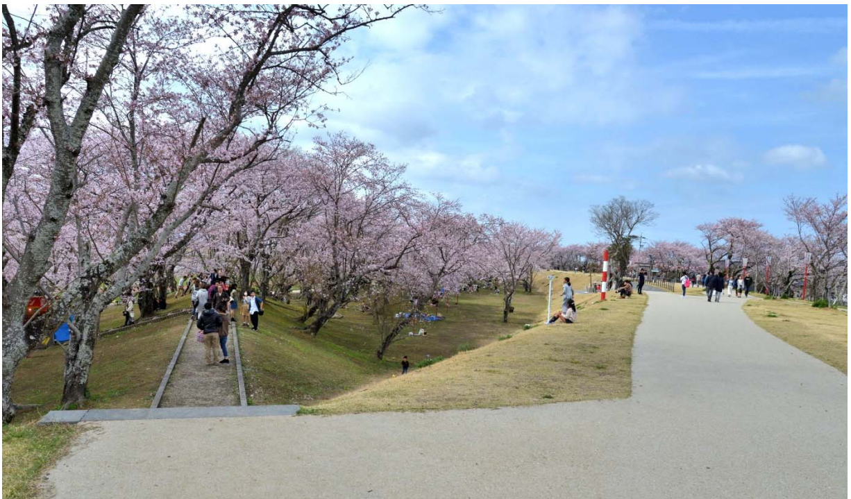
写真-3 整備前（上）と整備後（下）。写真左の堤防が駿河守堤と呼ばれる突出し堤。整備前の桜景観は素晴らしいが本堤防が狭い。整備後は堤防天端幅が5mから12mに広がり、伸びやかな空間に変貌した。腹付盛土による突出し堤長さの減少も最小限となり、景観的にも大きな変化は見られない。
