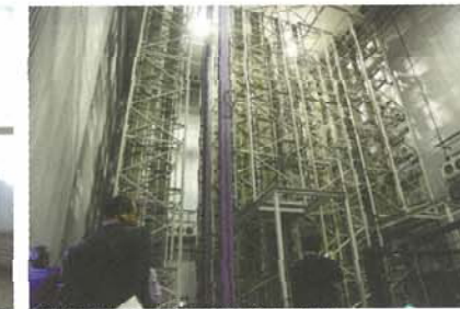
高鮮度保持立体予冷库の内部
